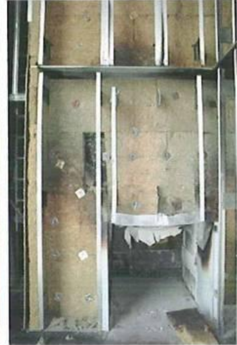
Abb. 11: Zustand der Unterkonstruktion unterhalb der ersten Brandsperre
