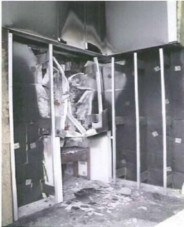
Bild 15: Zustand der Unterkonstruktion nach Entfernung der Faserzementplatten unterhalb der Brandsperre
