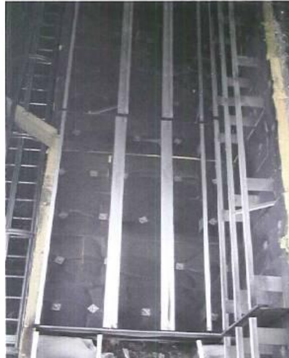
Bild 16: die Unterkonstruktion sowie die Dämmung oberhalb der Brandsperre weisen keine Schädigung auf
